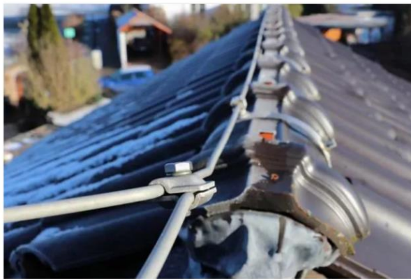
Bild 1: Verbindungsstelle in einem Blitzableiter-Netzwerk
