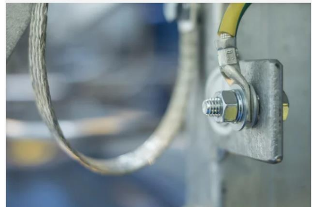
Bild 2: Erdungspunkt in einer Industrieanlage
